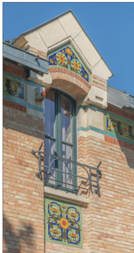
Ci-dessus : allège de la fenêtre du second étage de la façade latérale droite. Panneau cloisonné n° 136 en 4 éléments de 40 cm x 40 cm, vendu 45 F-or en terre cuite émaillée et 60 F-or en grès émaillé.
